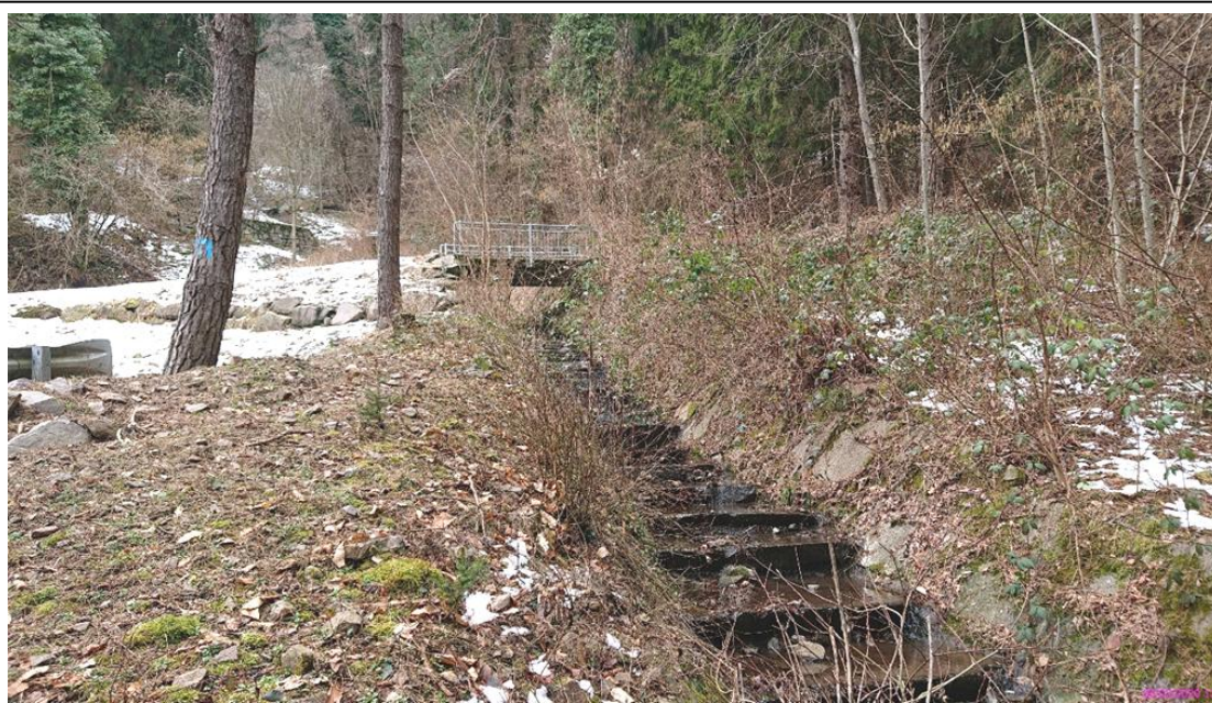
Fig. 3.48 – Canale consolidato tangente all'esterno del tornante. Eventuali fenomeni di fuoriuscita potrebbero essere causati dall'ostruzione dalla passerella.
