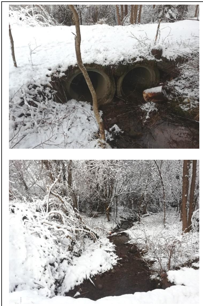
Fig. 3.16-3.17 – Canale naturale di smaltimento dei deflussi provenienti dal versante di Sover e dai canali da debris flow. L'attraversamento della strada avviene con due tubature in cls da 80 cm.
